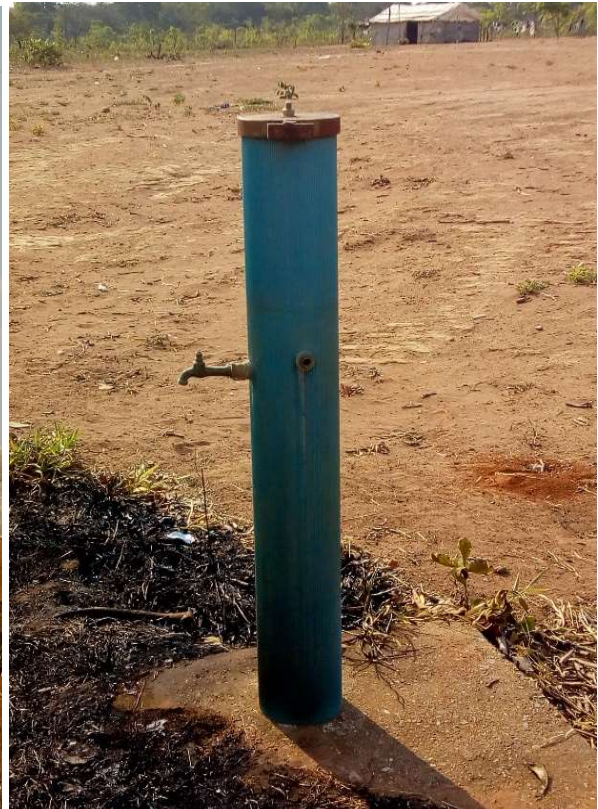
Figura 12: ponto de torneiras para captação de água.
